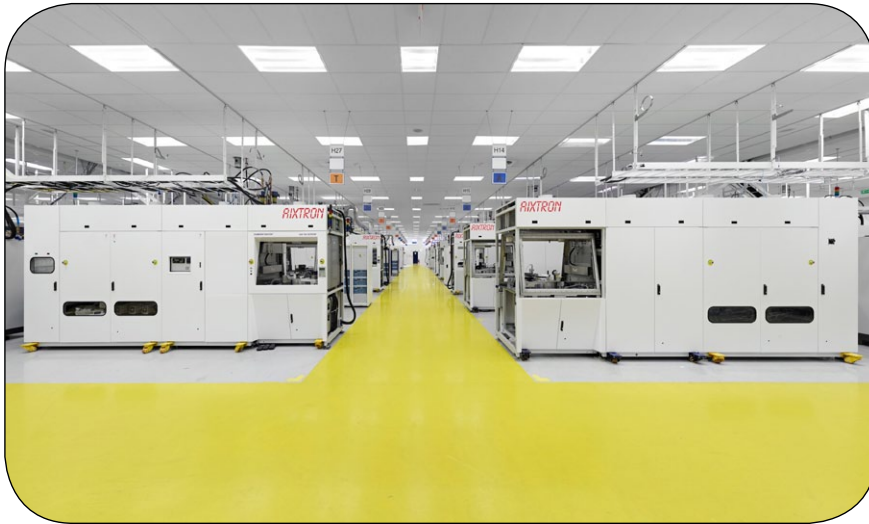
AIXTRON Production Hall
